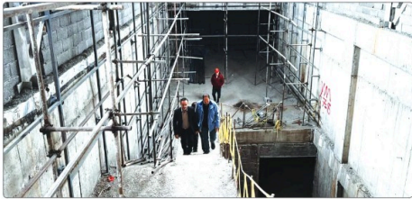
رئیس کمیسیون عمران و حمل و نقل شورای اسلامی شهر کرج گفت ایستگاه سه راه رجایی شهر تا نیمه اول خردادماه ۱۳۹۲ به بهره‌برداری می‌رسد.
